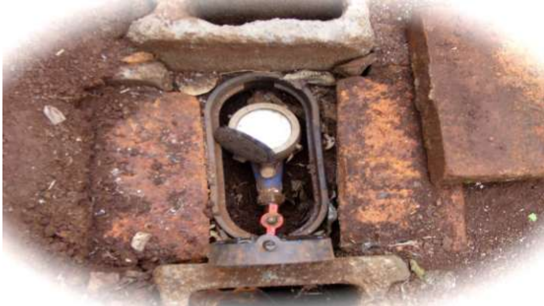
Mit dem Wasserzähler wird der Wasserverbrauch pro Familie gemessen
