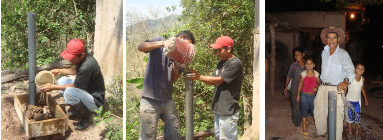
In San José wird die Hausinstallation vorbereitet und betoniert, seit Mai fließt das Trinkwasser
