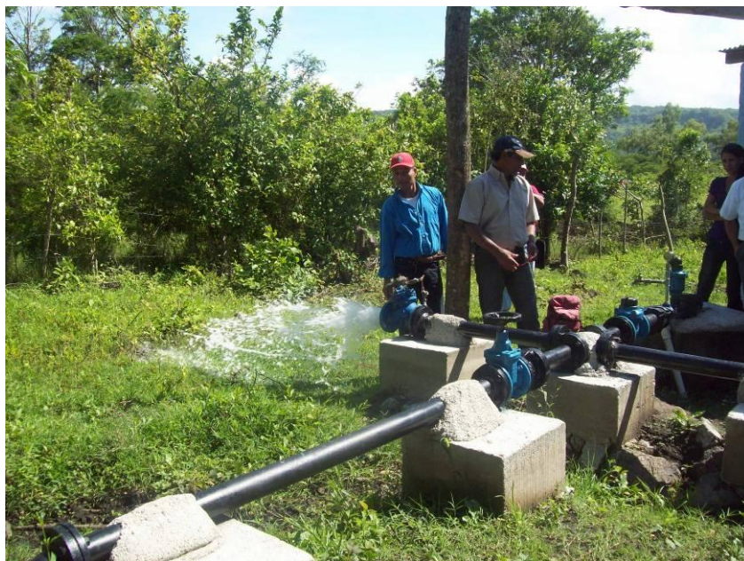
Estación de bombeo (área de poso),
