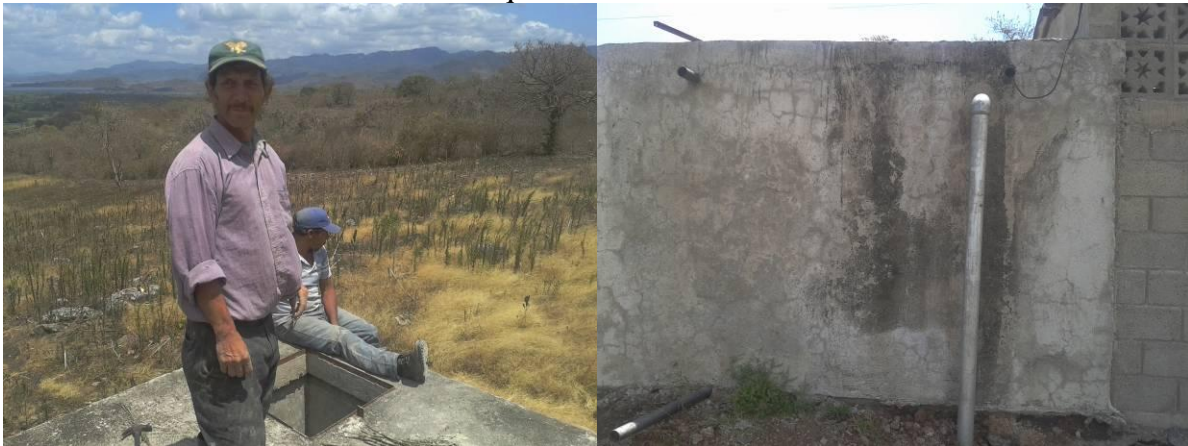
Tanque de Relevo N°1.
