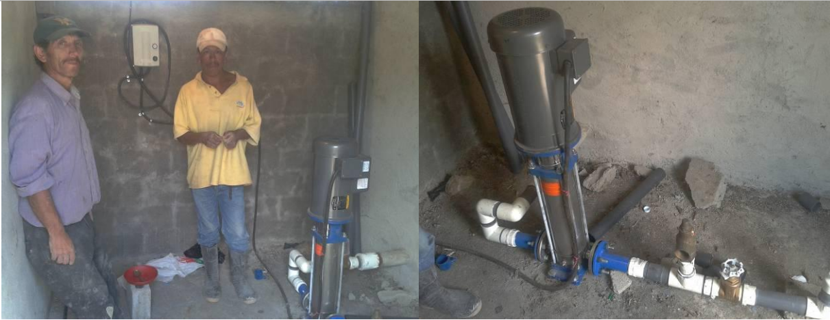
Estación de Relevo
